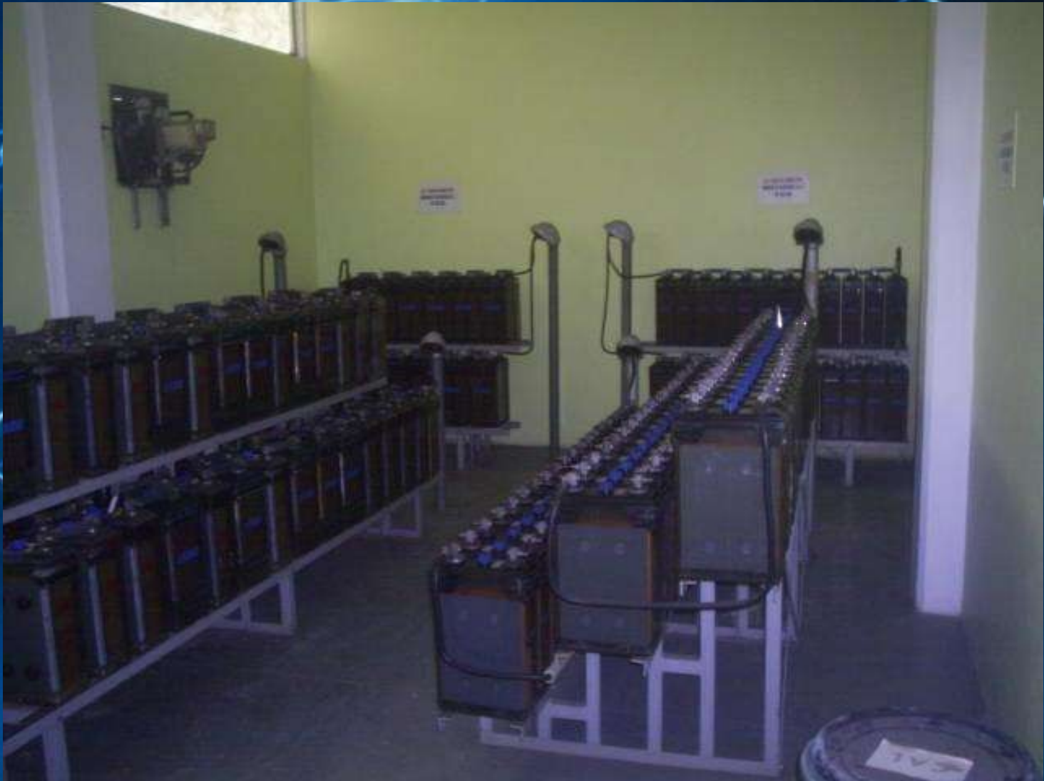
Banco de baterías
