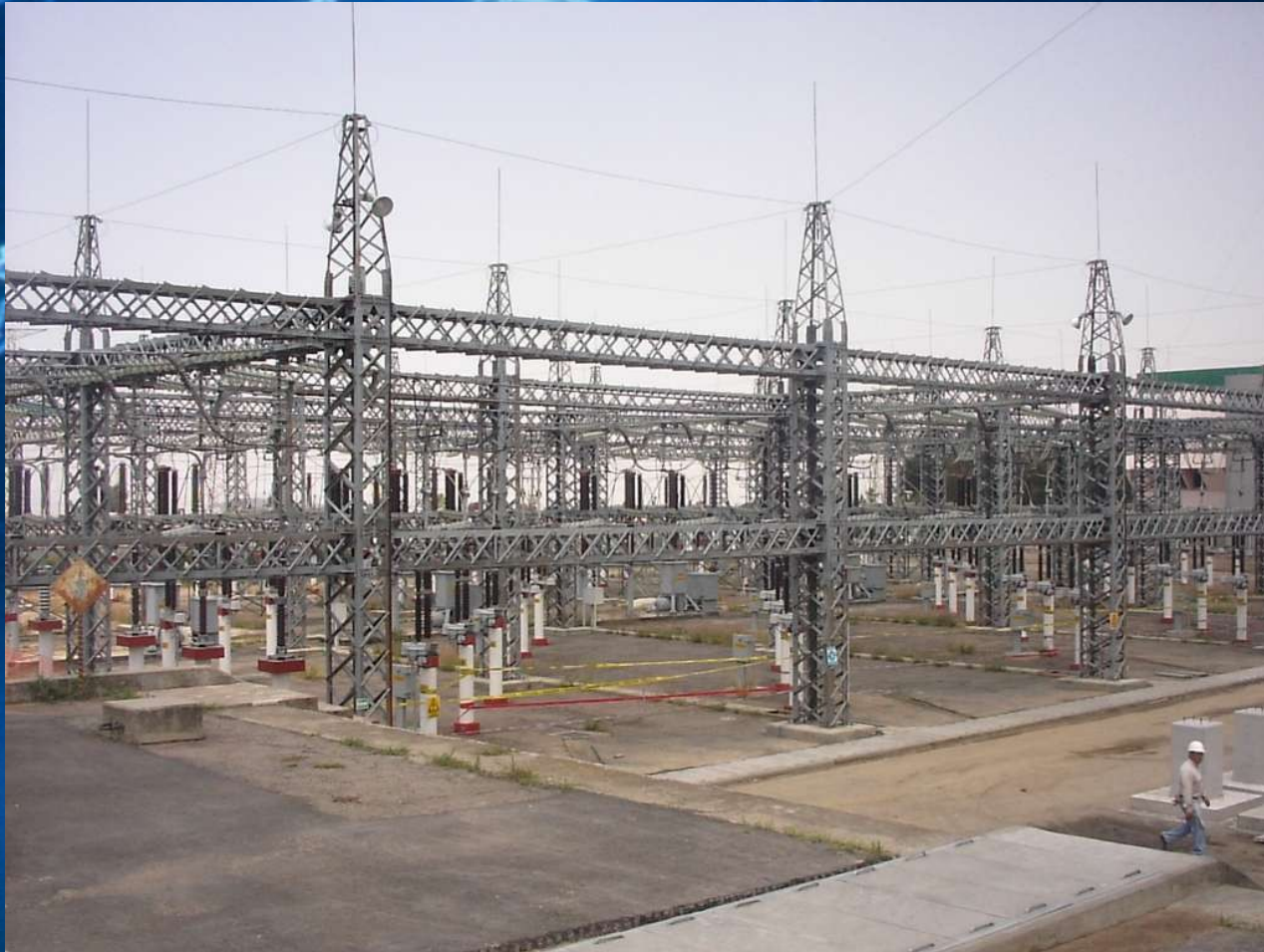
Subestación Puebla II Potencia
