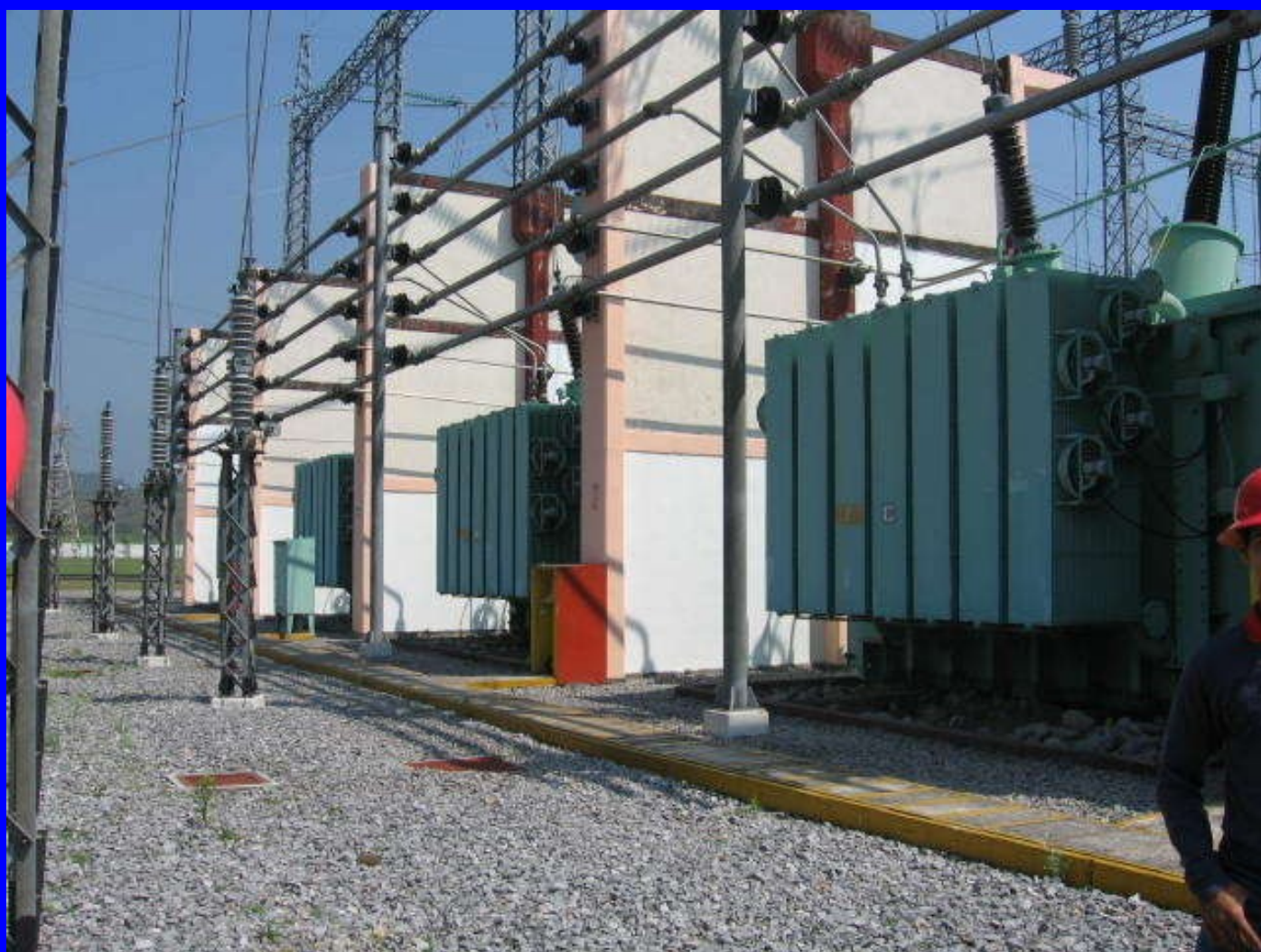
Banco de transformación
