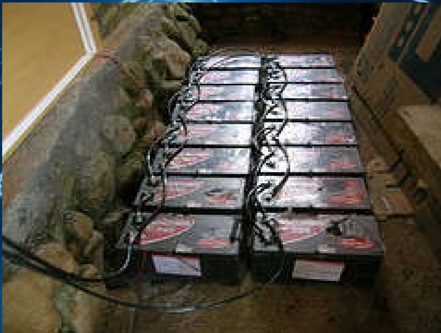
Banco de baterías
