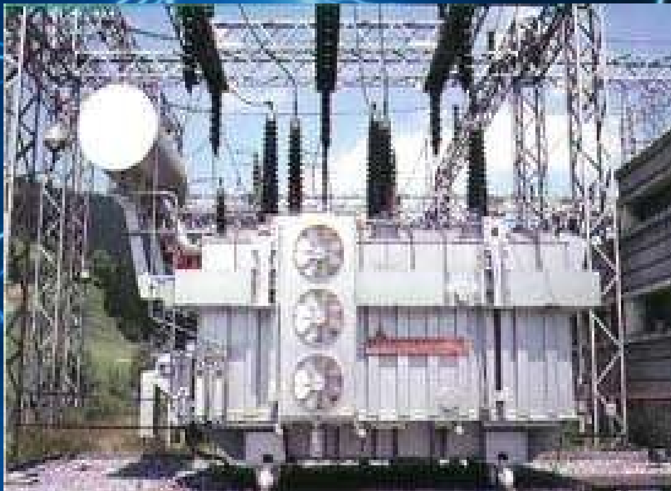
Banco de transformación
